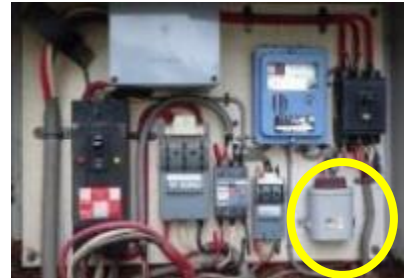
低圧分電盤内の低圧コンデンサー
